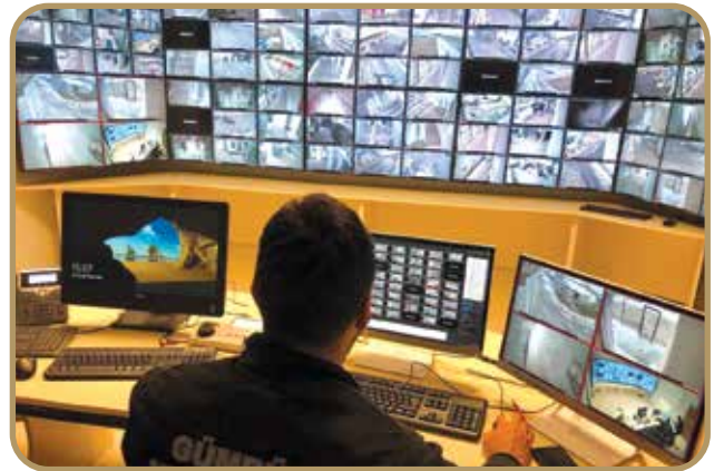
CCTV İzleme Odası, Çıldır/Aktaş
